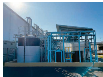
滋賀工場 排水処理設備
