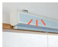
窓枠にあたっ て上がりきらない。
